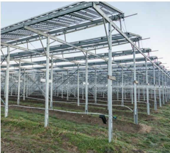
System von Insolight: bewegliche Module in 3,5 Meter Höhe.
