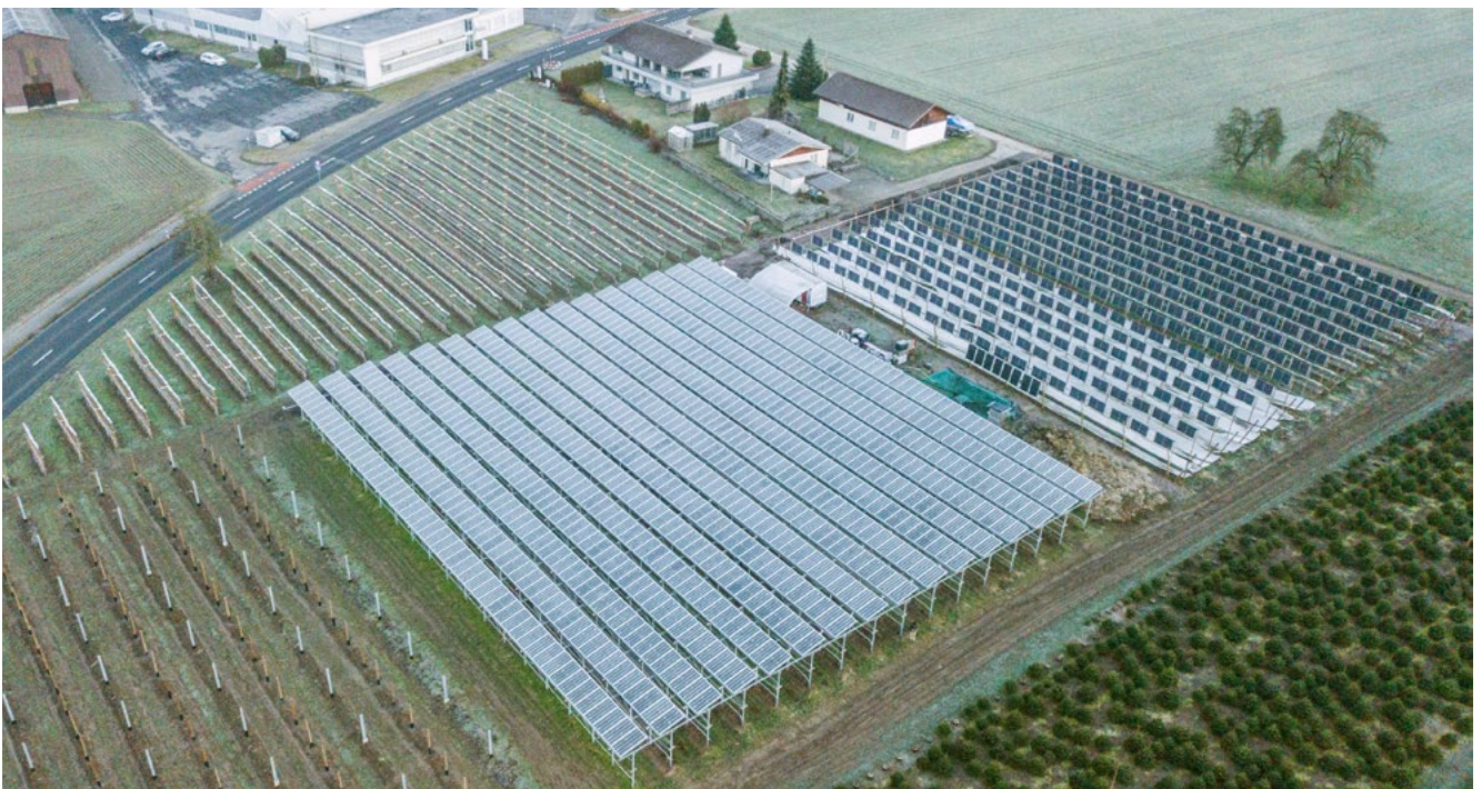
In Aesch LU steht die grösste, aus drei Systemen bestehende Agri-Photovoltaik-Anlage der Schweiz. Im Februar war ein Teil noch im Aufbau (links unten).
